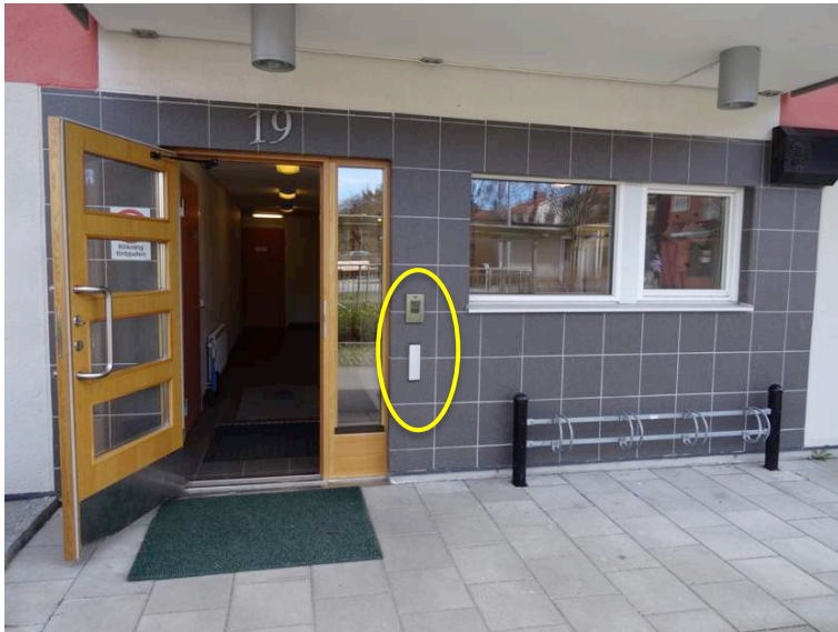
Exempel på trapphusentré som har gjorts tillgänglig med hjälp av en dörröppnare som också är kopplad till elektroniskt lås (se gul markering i bilden ovan).
