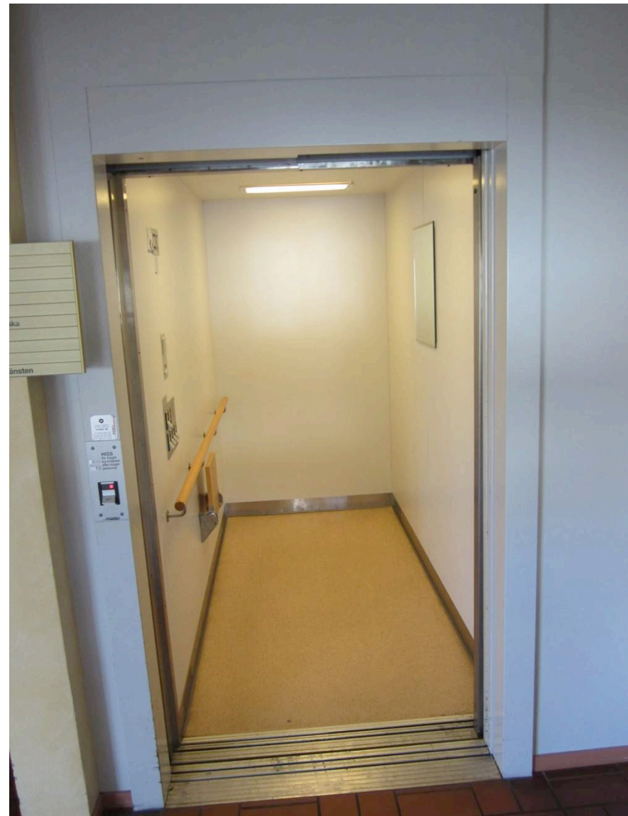
Exempel på en rymlig hiss som har dörrautomatik, ledstång, nedfällbar stol och där knappsatsen är placerad i mitten av hissen.
